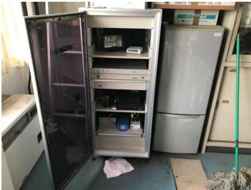
高洲 測定器本体
