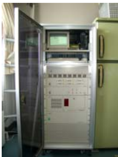
航空機騒音自動測定装置本体
