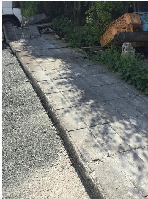
地震によりブロック塀が倒壊
