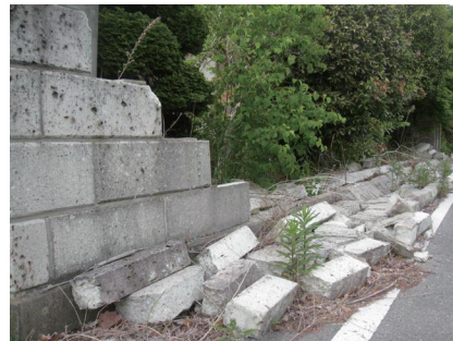
地震により石塀が倒壊
