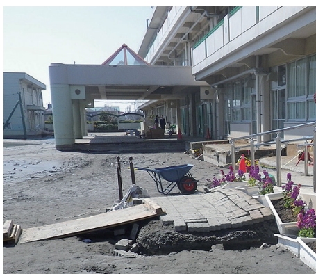
震災直後の明海小学校 液状化により校舎周りに土砂が噴出するなど 大きな被害を受けました。
