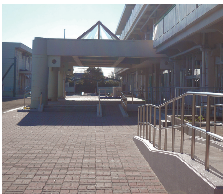
現在の明海小学校(平成25年1月撮影) 工事が完了し、きれいな学校に戻りました。
