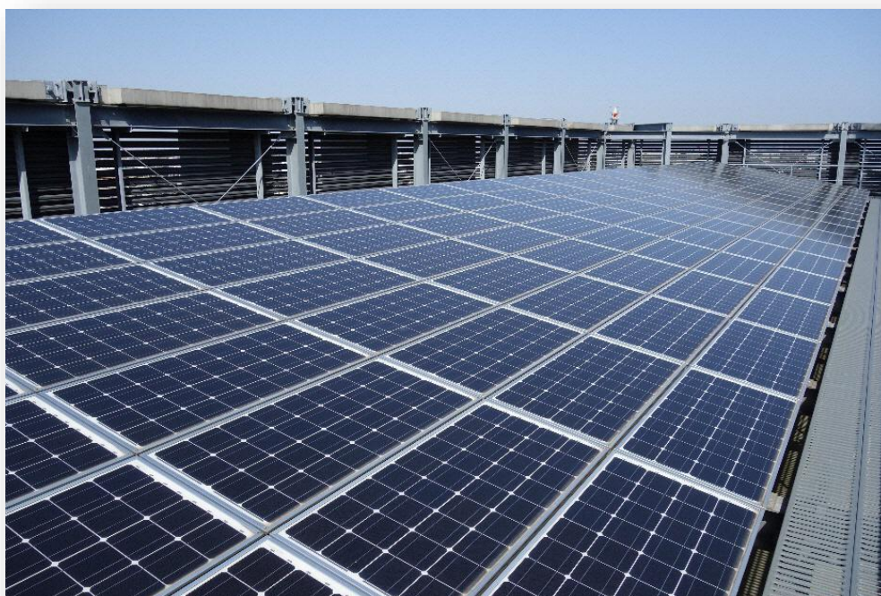
市庁舎の太陽光パネル
