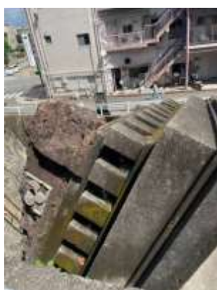
倒壊した浦上天主堂の 旧鐘楼の瓦礫
