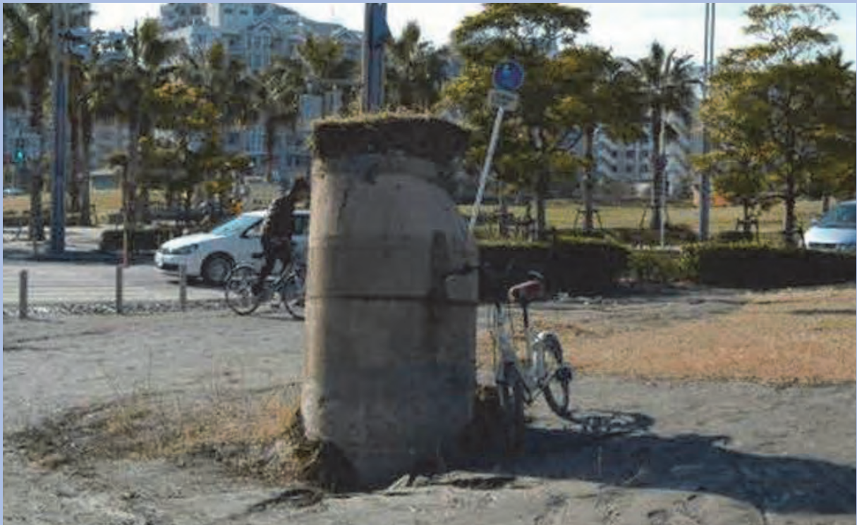
地震によるマンホールの突出(明海地区)
