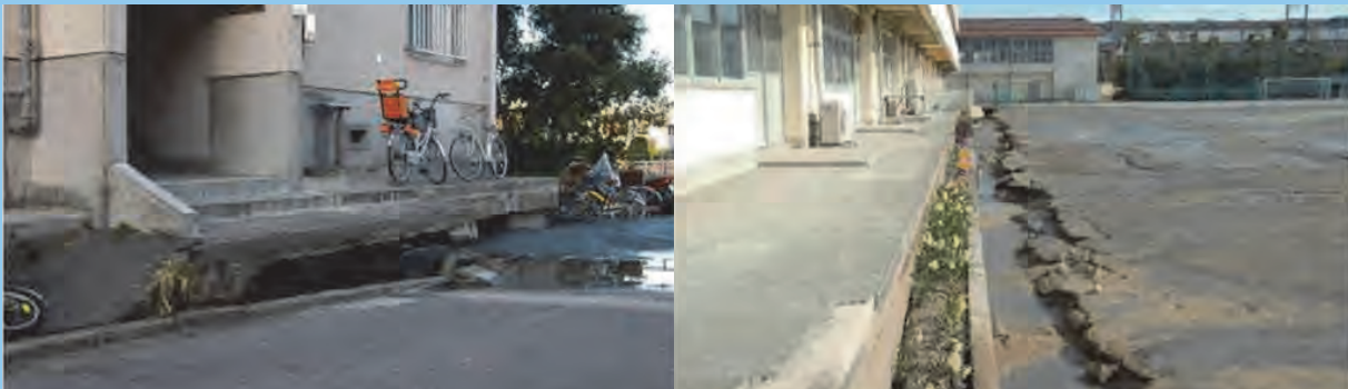
大、中規模建物の被害状況(周辺地盤の沈下)
