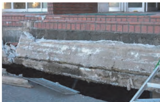
市内私立学校玄関の陥没
