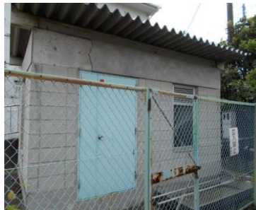
新橋横ポンプ場
