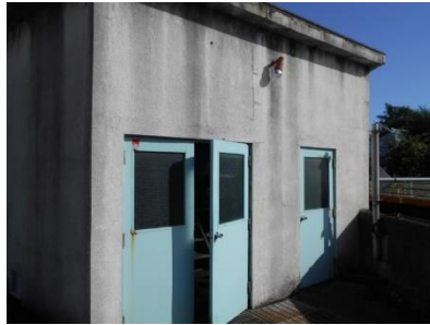
山城屋前排水機場
