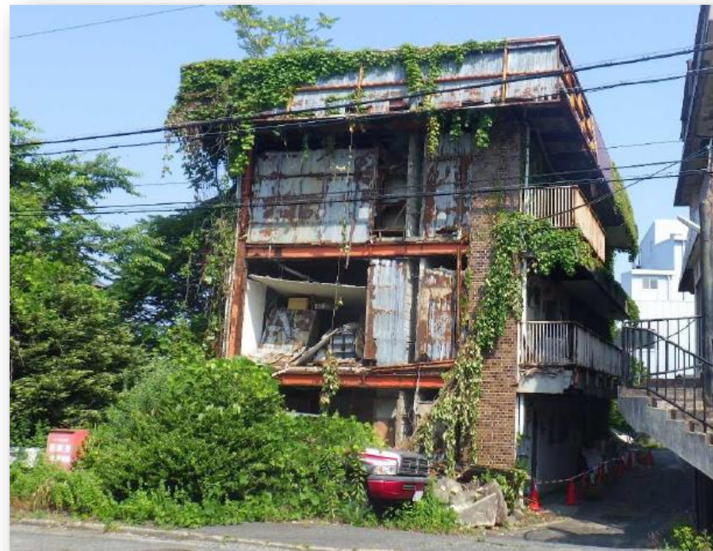
国土交通省近畿地方整備局 「区分所有建物の空き家等に対する代執行の事例について」より引用
