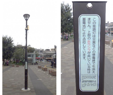
写真6-1-5 蓄電池式照明施設
